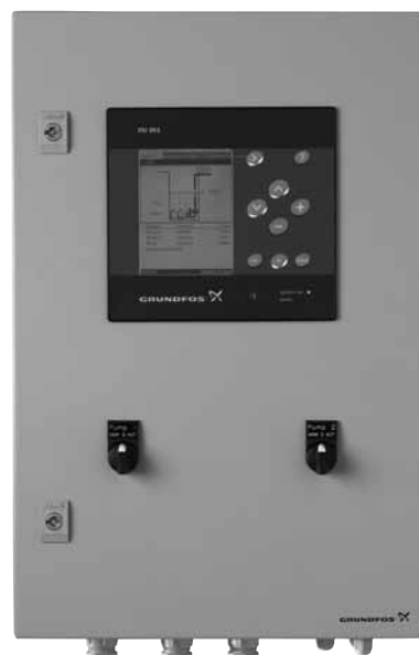
Rys. 50 Szafka sterownicza Sterowników Dedykowanych
